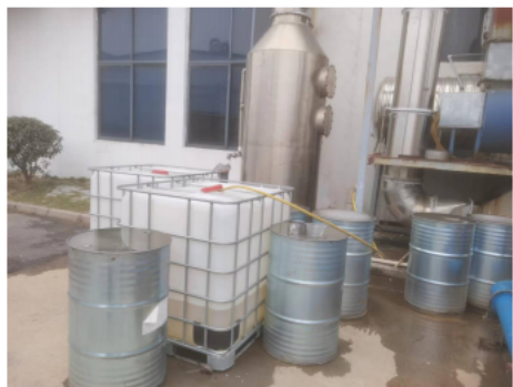
NMP 回收装置
