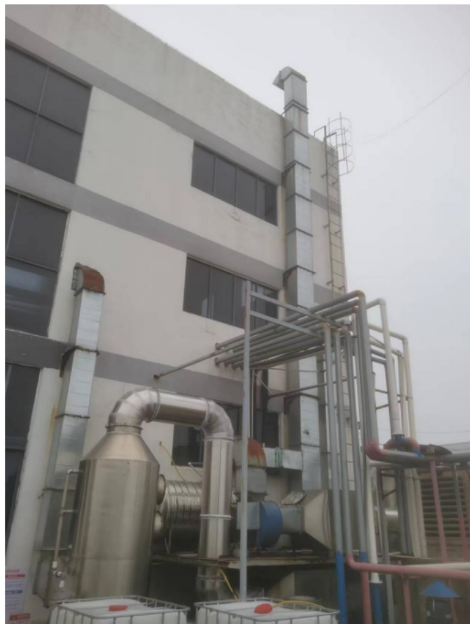
涂布烘干废气处理装置
