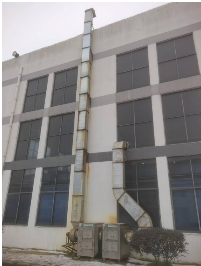
注液废气处理装置
