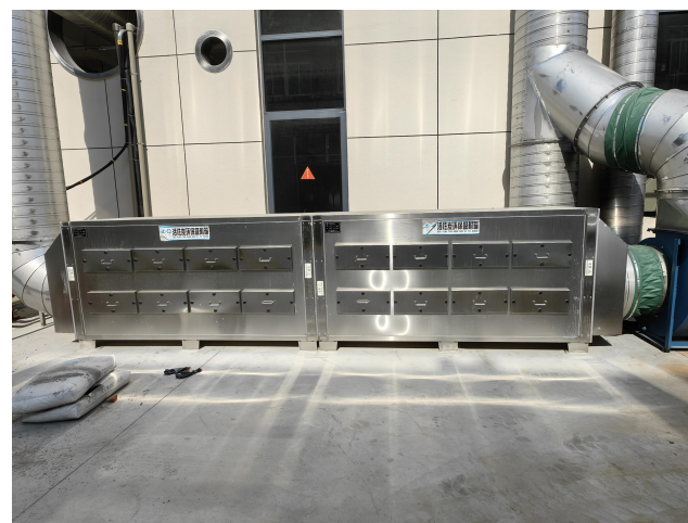
废气处理设施
